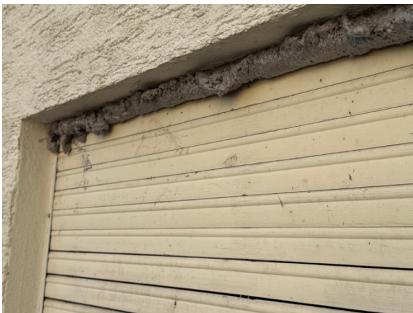
Abb. 6: Mit Bauschaum abgedichteter Spalt zwischen Wand und Rollladen.
