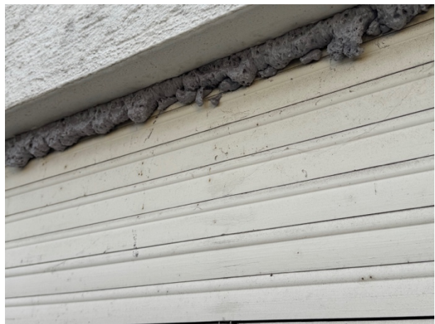
Abb. 7: Mit Bauschaum abgedichteter Spalt zwischen Wand und Rollladen.
