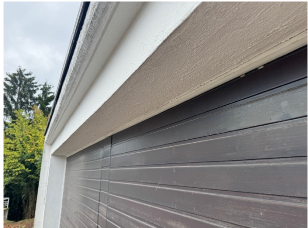
Abb. 13: Breiter Abstand zwischen Atika und Außenwand ohne Quartiereignung.
