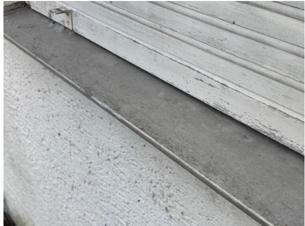
Abb. 9: Fenstersims unterhalb eines Rollladenkastens der Ostfassade des Wohnhauses ohne Kot.
