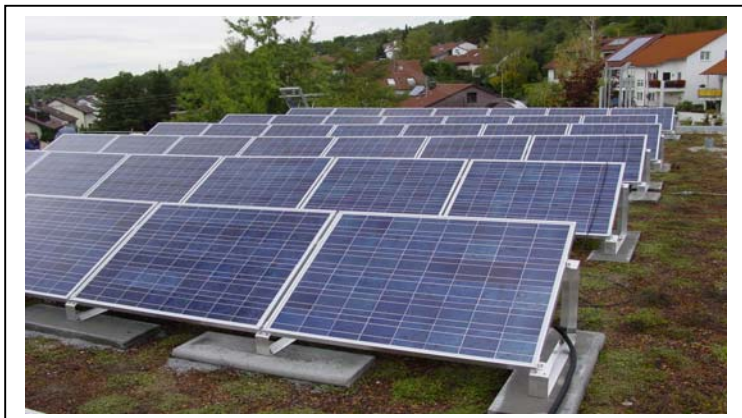
Photovoltaikanlage der WinnSolar GbR auf der Grundschule Birkmannsweiler
